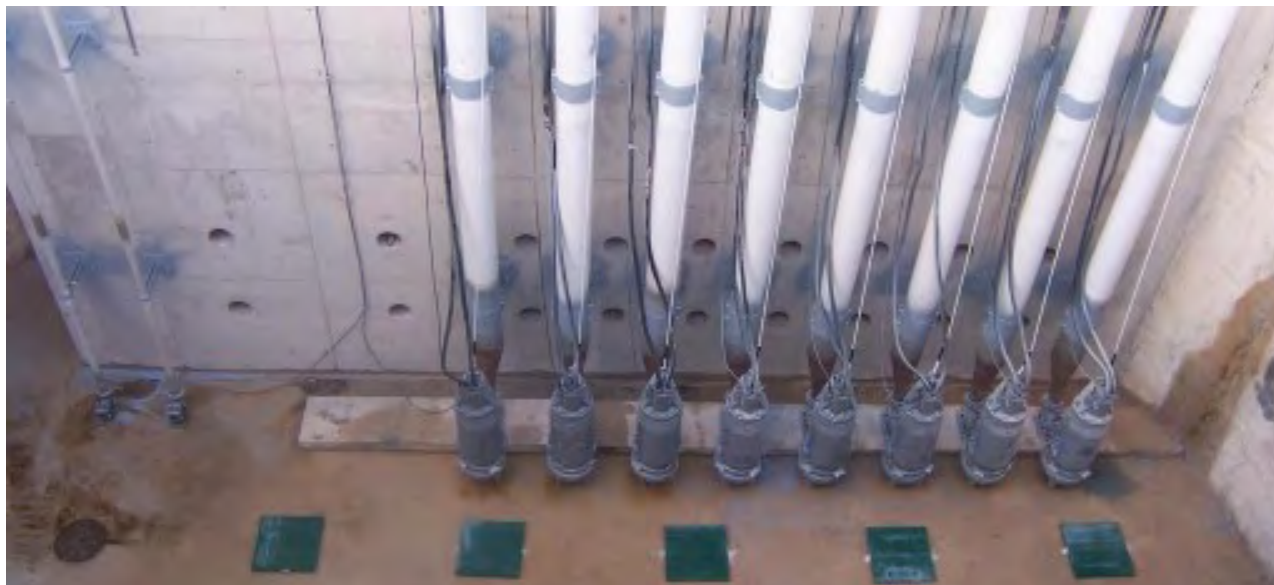
Figura 38. Instalaciones en la cántara de bombeo. / Tomado de iAgua.
