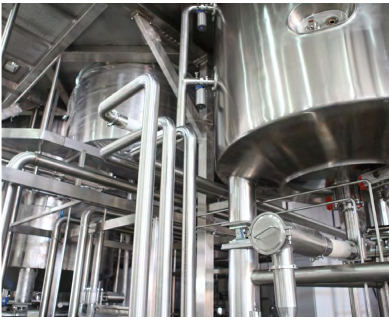
Figura 21. Generación, distribución y almacenamiento de agua PW, WFI, y PS Diálisis. / Tomado de Rosemblak Scientifica.
