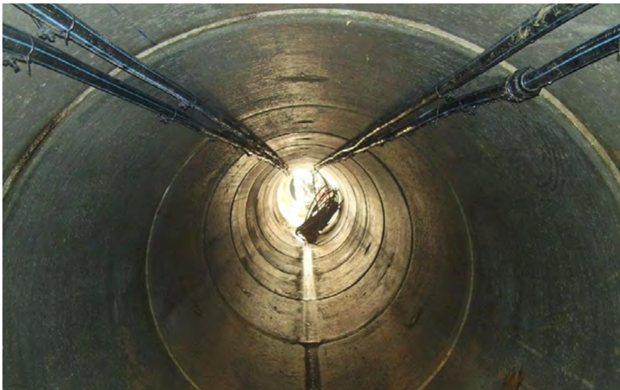
Figura 37. Interior del sistema de conducción antes de ser activado. / Tomado de iAgua.
